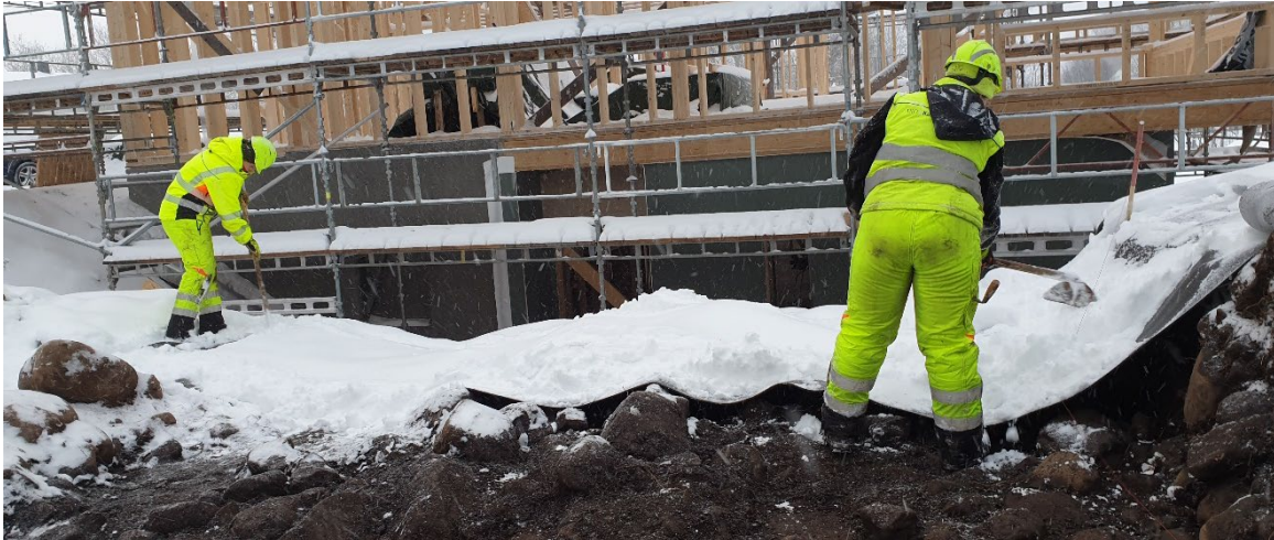
Figur 11: Snøfjerning – isolasjonsmattene ble krafset rene før de ble rullet opp; med SB og NNØ (Cf54058_974).
