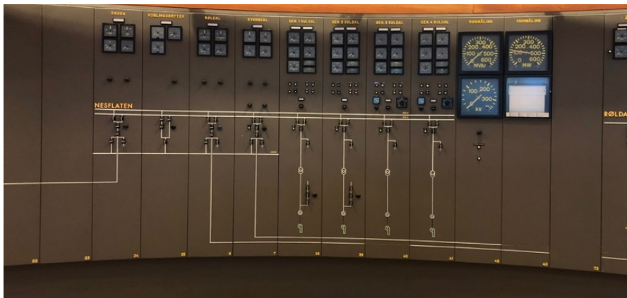
III. 5.17: Detalj av kontrollpanelet. Foto: Eget, 19.10.2021.
