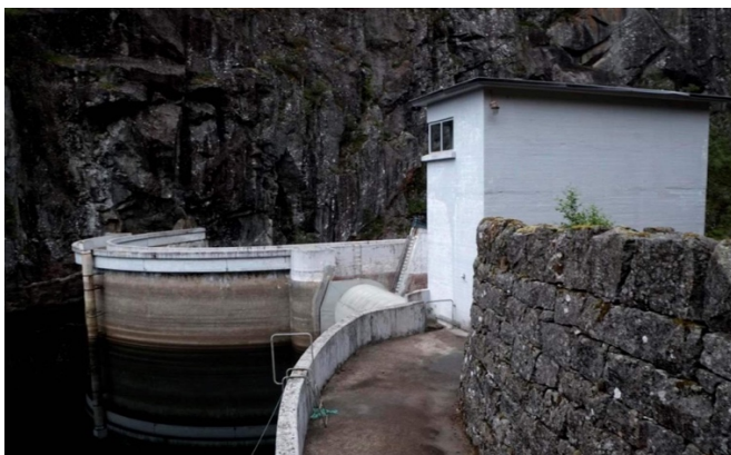
III. 2.2: Bjerke og Eliassen. Dam og lukehus. Storlivatn. Foto: Unn Yilmaz, NVE. U.å. Hentet fra: https://www.nve.no/om-nve/nves-utvalgte-kulturminner/dammer/storlivatn/ Hentet 12.09.2021.
