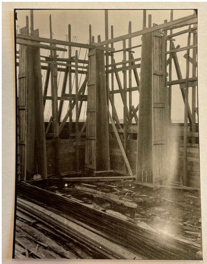
Figur 11: Forskalling av hallens søyler. Foto av Bjercke og Eliassen. Studiesalen, Nasjonalmuseet – Arkitektur. Ukjent årstall
