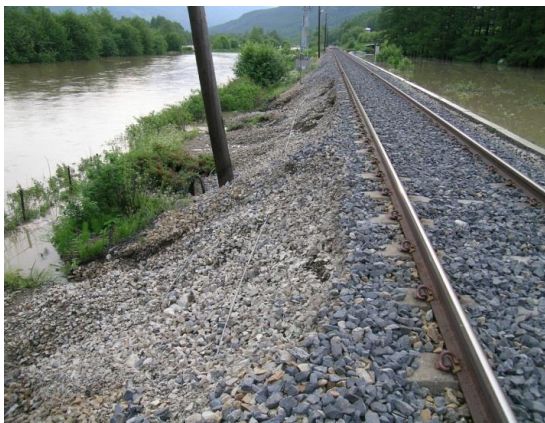
Figur 8: Erosjon på bane i Gudbrandsdalen som følge av flommen i 2011. (Jernbaneverket, u.å.).
