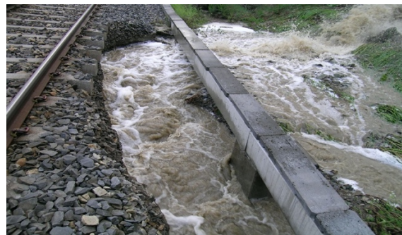
Figur 9: Erosjon på bane som følge av flom i sideelv under flommen i 2011 i Gudbrandsdalen. Det er fare for skade på det elektriske anlegget som ligger i betongkanalen til høyre i bildet. (Jernbaneverket, u.å.).
