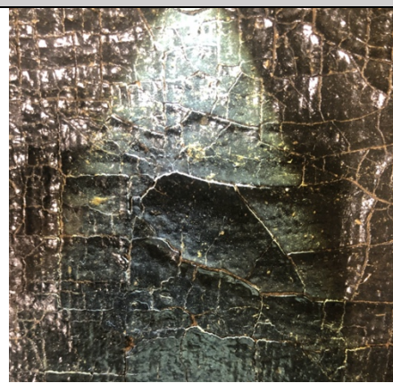
Figur 23 Detaljopptak av oppskalling i sidelys.
