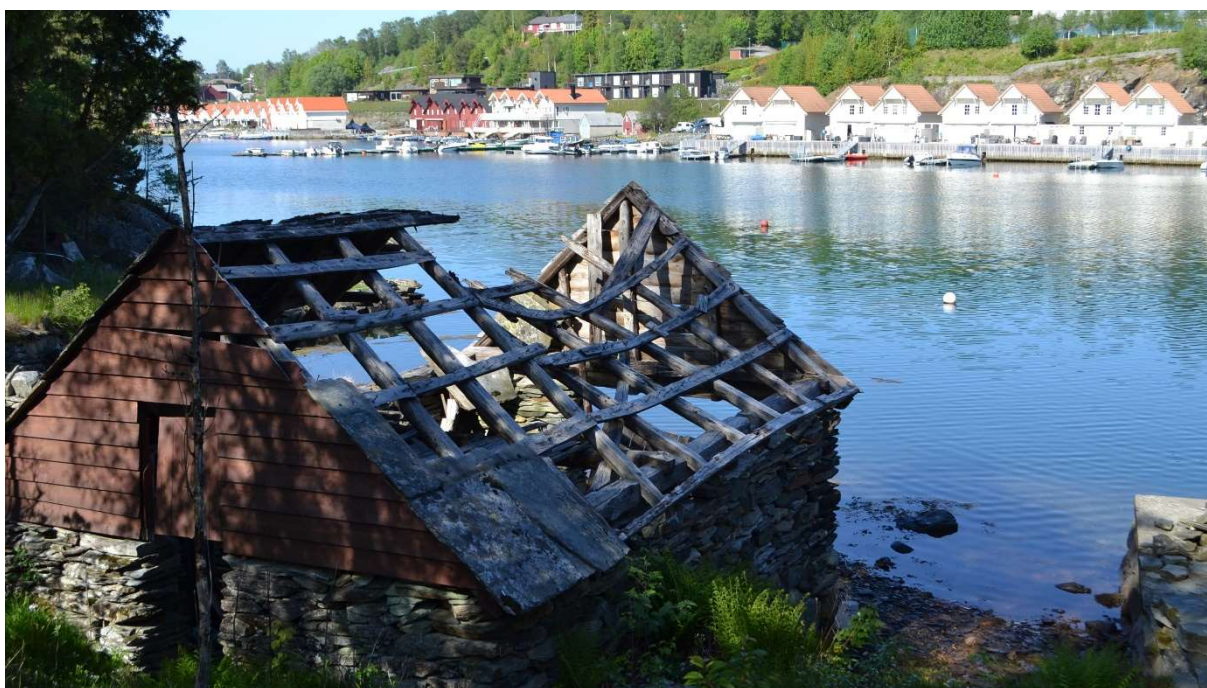
Figur 23: Døme frå Tveitavika som viser korleis utbygging mange stader vert prioritert framfor vedlikehald av eldre bygningar. Foto: Forfattaren.
