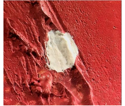
Fig 87) Kitting ved den største avskallingen – imitert overflatetekstur.
