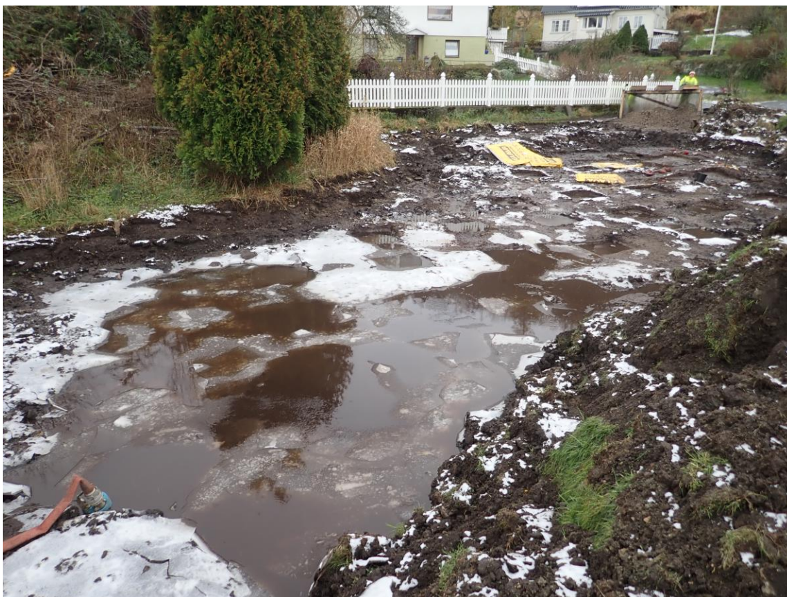
Figur 8. Oversikt over Andabeløy lok. 2. Et stort vanntilslag og fravær av drenering gjorde gravingen tidvis problematisk. Når frosten satte i den nest siste uka førte dette til ytterligere utfordringer. Vintermattene som kan ses i bildet hjalp noe, men bakken utenfor disse tinte ikke i løpet av dagen da fjerningen av matjord gjorde at kulden sank ned til flaten og heiene i sør gjorde at solen ikke traff lokaliteten i løpet av hele utgravningsperioden.
