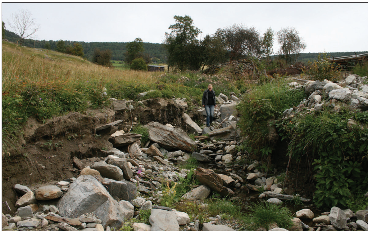
Figur 28.5. I Fron er det lite som holder på jordmassene i de bratte dalsidene ved store nedbørmengder og flom. Det gir vannet stor kraft og forårsaker ofte dype skred og flombrudd. Her med Tina Villumsen på Grytting I etter juli-flommen i 2013. Foto: Ingar M. Gundersen.
