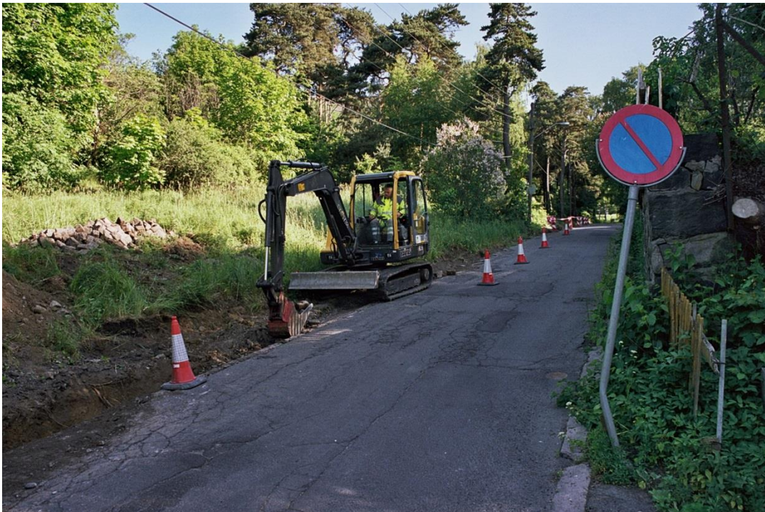
Figur 6. Undersøkellesområdet sett mot nordvest. Langs Karlsborgveien var undergrunnen forstyrret av tidligere veiarbeid, og det ble med unntak av enkelte prøveruter, kun foretatt overvåkning mens tiltakshaver gravde kabelgrøften med gravemaskin (foto: Lasse Jakslund/KHM). cf35266_16.jpg
