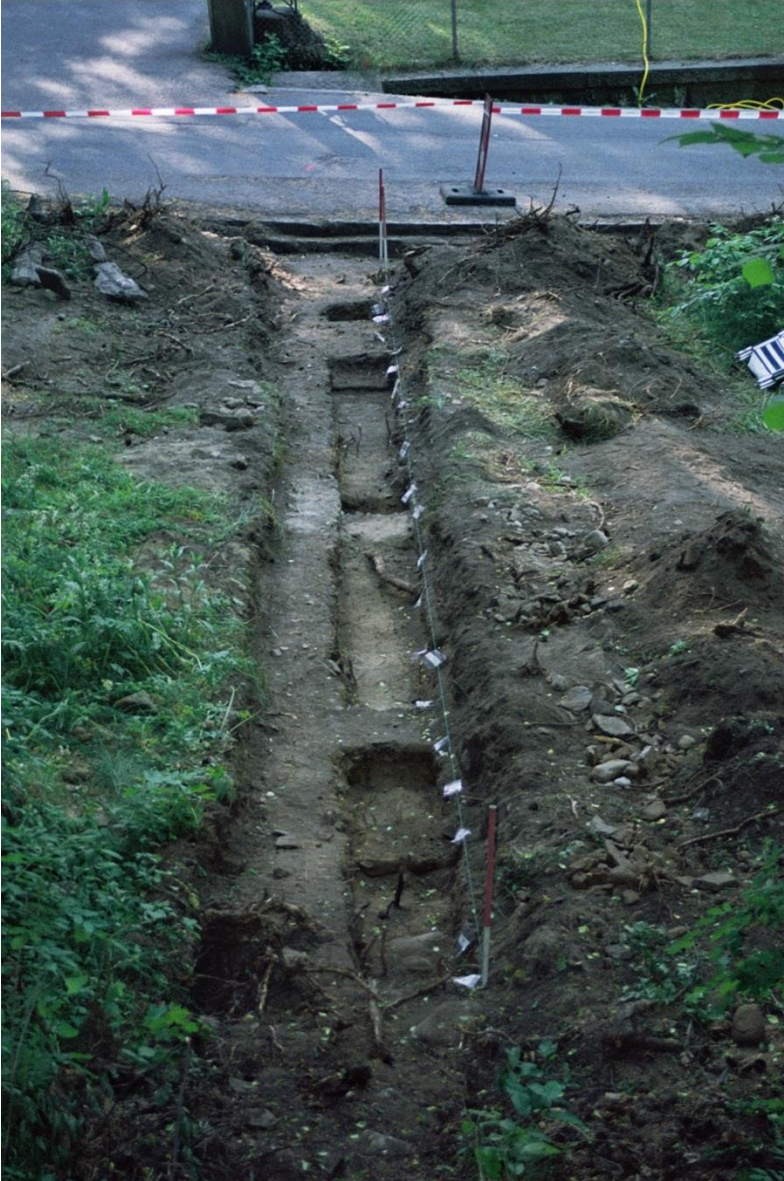
Figur 7. Ca. 15 meter av den 50 cm brede kabelgrøften krysset et funnførende grøntareal. Her ble det gravd flere lag manuelt i graveenheter på 50x50 cm, med tykkelse 10 cm. Stratigrafien viste at undergrunnen bestod av hagebrukte/dyrkede, homogene masser, stedvis med søppel og nyere funn til bunns. Det påvist en del skjørbrent stein, men det meste trolig omrotet i moderne tid (foto: Lasse Jaksland/KHM). cf35266_22.jpg
