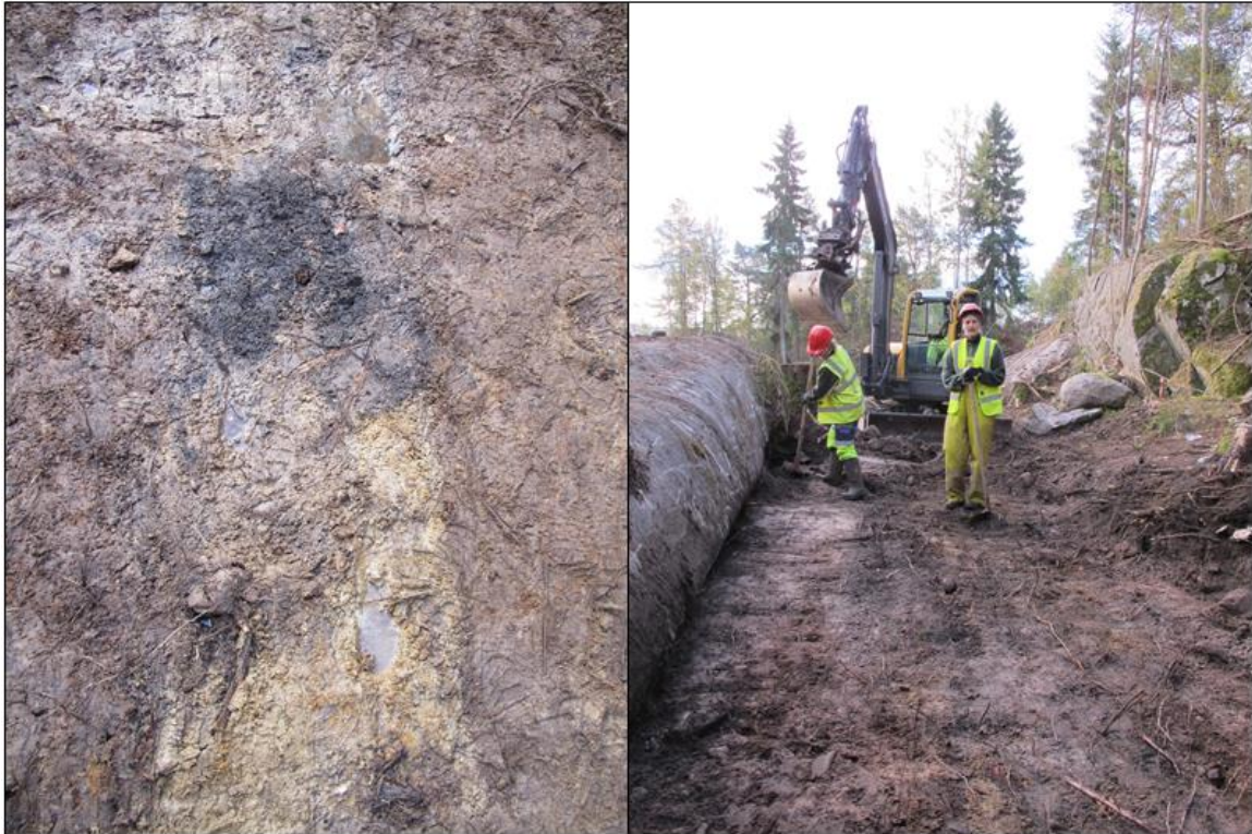
Figur x. Til høyre: Flateavdekning på Stokke/Polland 5 ved Synnøve Viken og Solveig Lyby, rett sør for Stokke/Polland 4. Til venstre: nærbilde av den nedgravde vannledningen som forstyrret begge lokalitetene.
