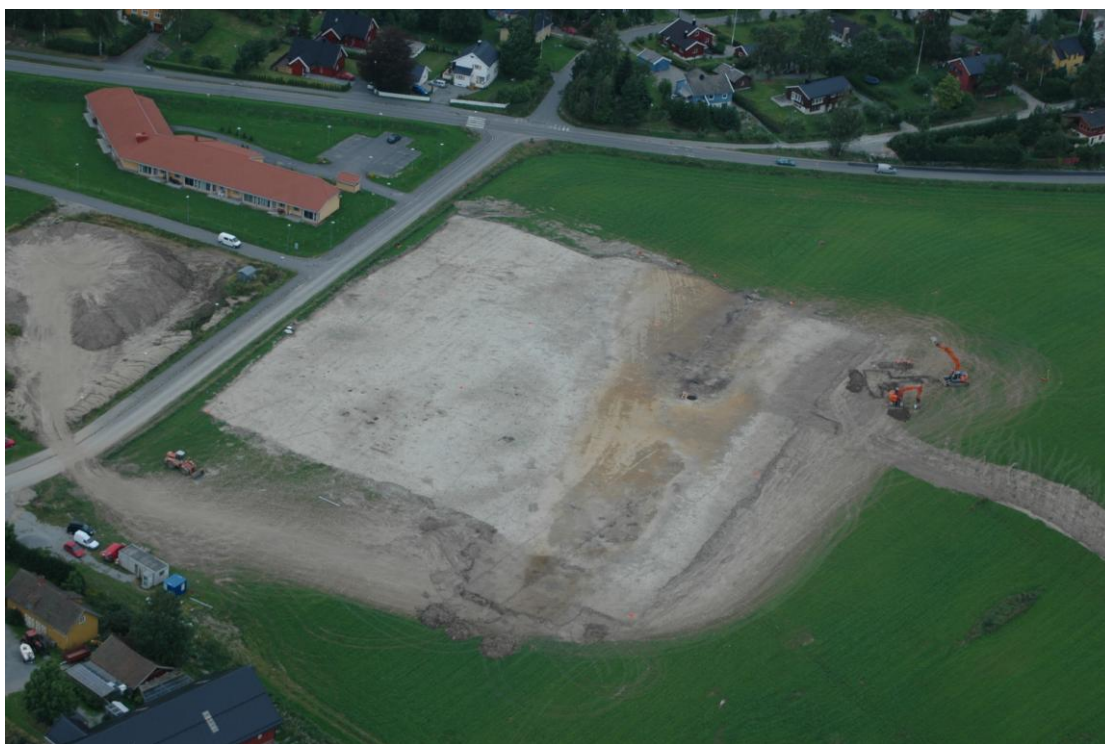
Fig. 5. Felt 1 sett mot NV. Område bearbeidet med grubb ses som mørkere grå stripe lengst til høyre i bildet, nærmest gravemaskinen. Flyfoto v/ Tom Heibreen.
