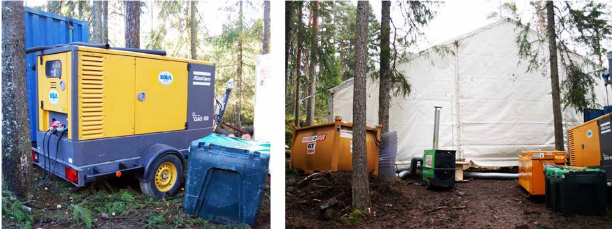
Figur 27: Stillestående aggregat, tilførsel av diesel og varmepumpe (Cf34760_229 og 320). Foto C. Eymundsson 2013.
