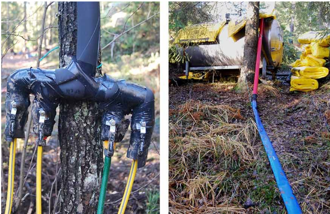
Figur 19: Trykktank og isolert vannfordelingssystem, hovedtilførsel av vann fra tjernet til trykktanken ble etter hvert dekket med isolasjonsmatter (Cf34760_215 og Cf34760_220). Foto C. Eymundsson 2013.
