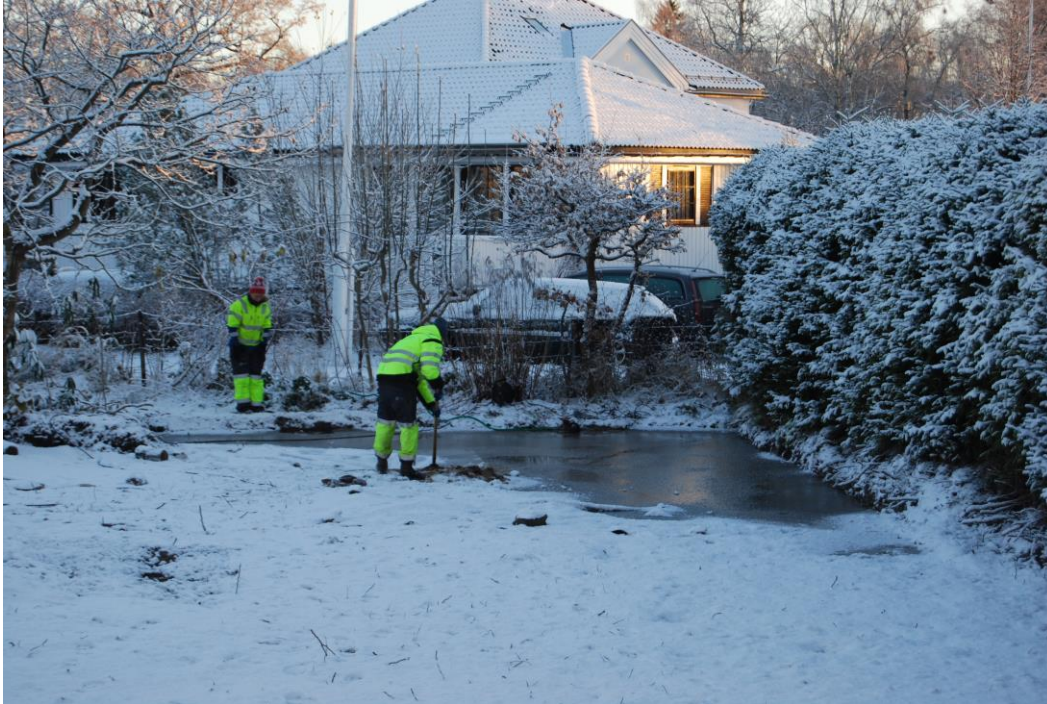
Figur 2: Arbeidsbilde Cf34610_016.JPG. Dårlige dreneringsforhold i sørvestlige del av felt, påfulgt av frostnatt og snøfall. Foto: Erlend Nordlie.
