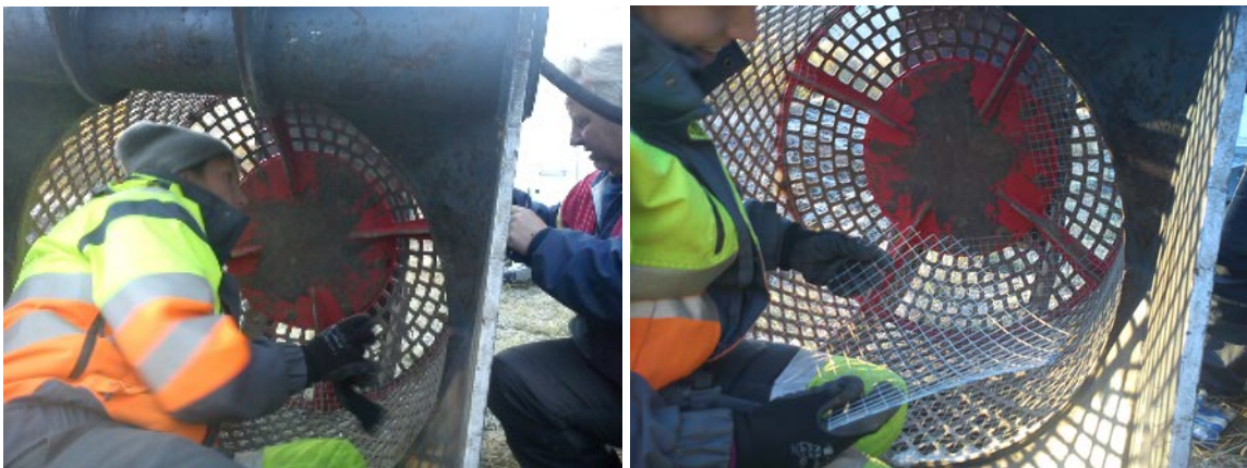
Figur 4: Arbeidsbilde av Carine Eymundsson og Ståle Berg som fester ståltrådnetting på innsiden av maskinell trommel. Cf34600_85. Foto G. Hansen 2012.
