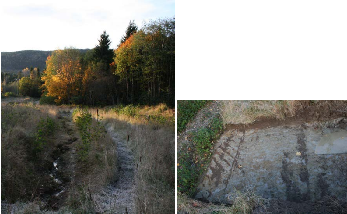
Figur 7: Erosjonsrenne etter sterk vannføring (t.v.) og bulldoserspor i undergrunn (t.h.). (Cf34006_8 og _11). Foto C. Eymundsson 2012.
