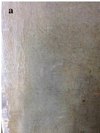
Figur 54: Antydning til diagonale sprekkdannelser i nedre, venstre hjørne.
