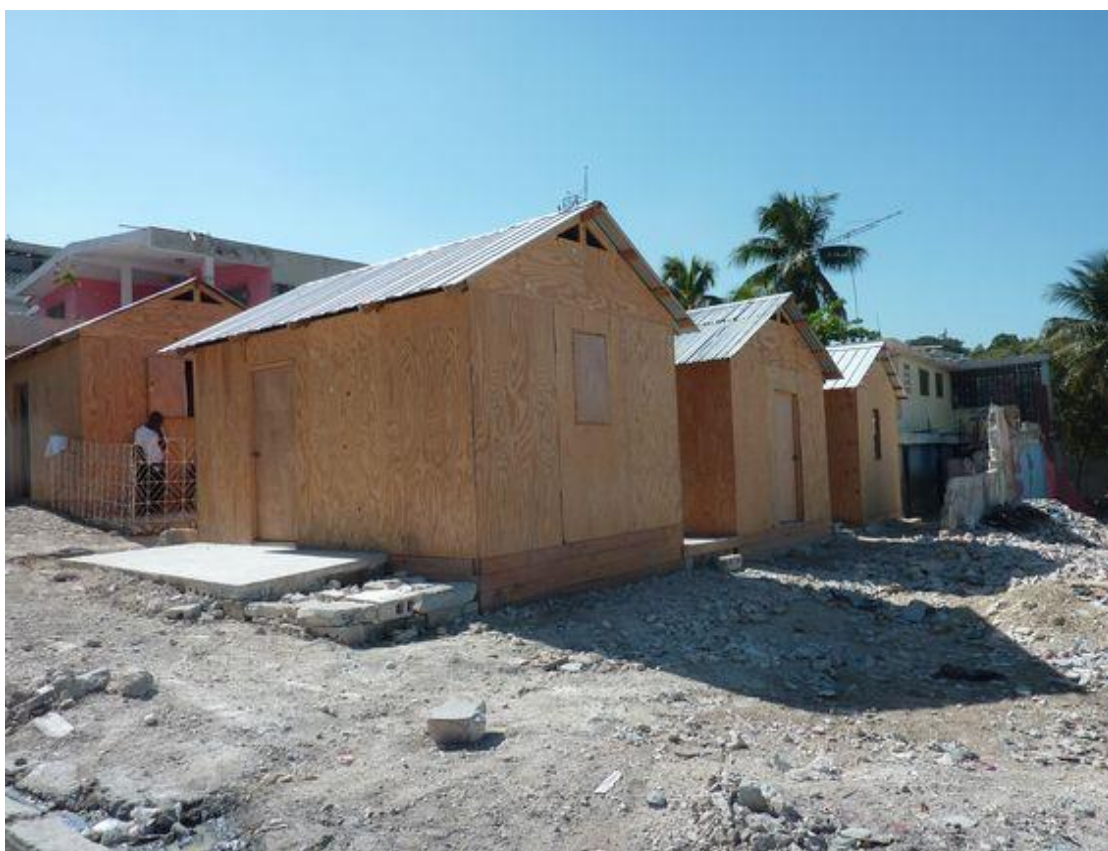
Photo 1 « On ne reconstruit pas une ville en posant de petites maisons précaires côte à côte ». Installation d'abris provisoires à Port-au-Prince. Photo prise par Béatrice Boyer, tirée du site : http://www.revue-urbanites.fr/ville-et-catastrophe-naturelle-responsabilites-et-opportunités-cas-du-seisme-de-port-au-prince/ Consulté le 3 mars 2016.
