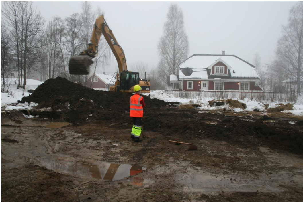
Figur 2: Avtorving med gravemaskin. Jone Røst Kile ved krafssa, bildet tatt mot nord (cf34214_02). (Foto: AJN).
