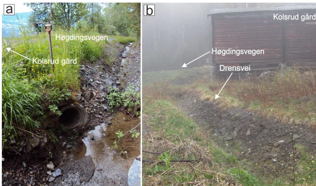
Figur 8.37 Detaljer i området ovenfor skredet. a) Ovenfor Kolsrud gård er Høgdingsvegen. Vann dreneres langs med veien i en grøft, men også under veien i en stikkrenne som frakter vannet videre ut på jordet nedenfor gården (se figur over for nærmere lokasjon).
