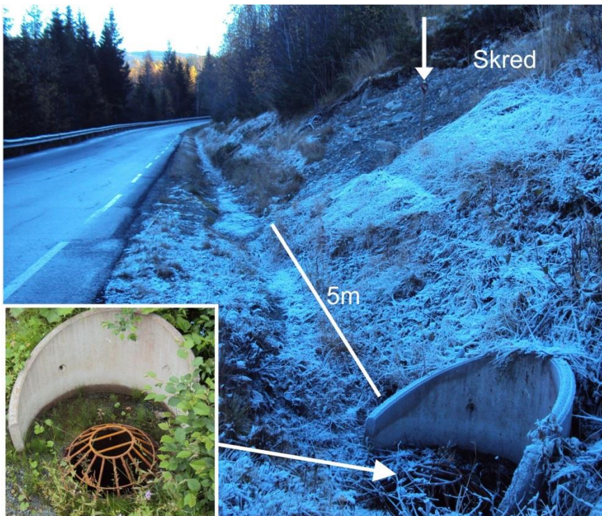
Figur 8.17 Beliggenheten til fv. 33 og kummen i forhold til skredsåret (hvit pil viser spade til skala).
