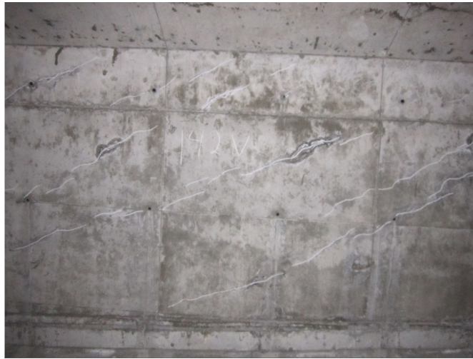
Figur 9.2: Illustrasjonsfoto av riss i steg på Sålåsund bru
