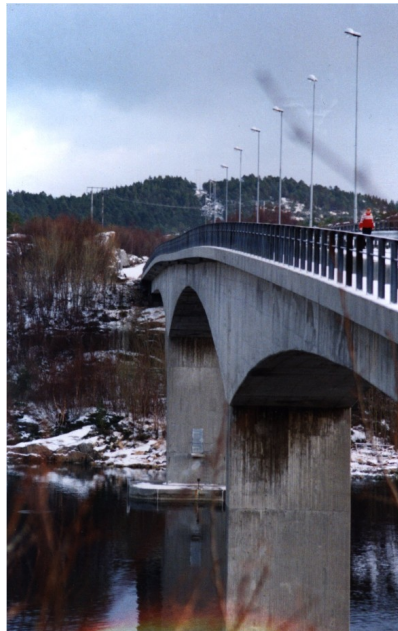
Figur 9.1: Illustrasjonsfoto av deformasjoner i Sålåsund bru
