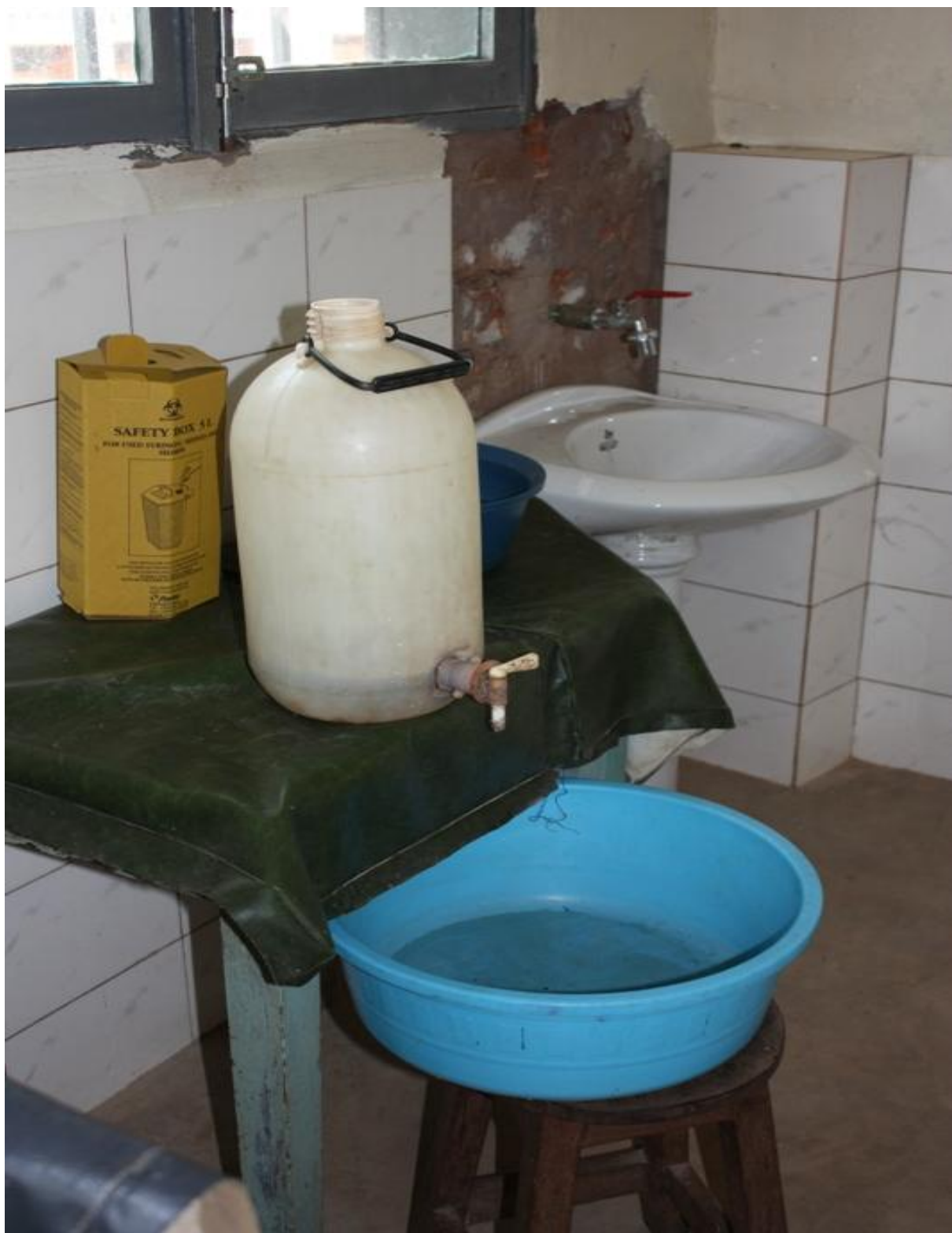
L'approvisionnement en eau dans un centre de santé, Kasongo
