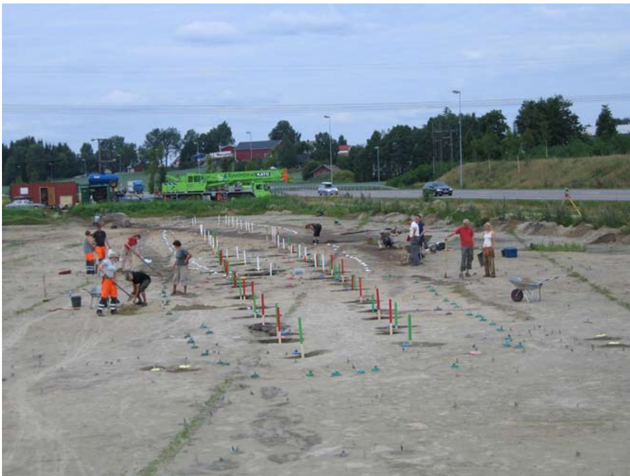
Figur 9_16: Hus 2 sett mot nord. Mørke stikker markerer stolpehol for takberande stolpar i hus 2. Kvite stikker markerer stolpehol for takberande stolpar i hus 1. Foto: E6-prosjektet Østfold, Kulturhistorisk museum.
