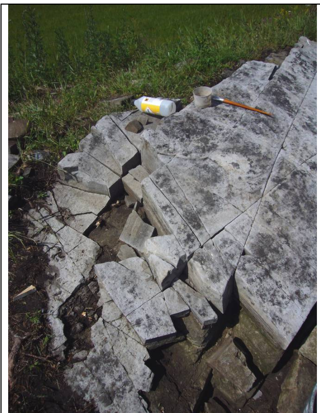
Figur 3.2: Helleristningsberg av sandstein skadet av rotsprengning fra trær. Ås I, Gjerpen, Skien, Østfold (eget foto).
