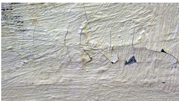
Ill.40 Felt 28: Blå farge kan sees i krakeleringer og avskallinger
