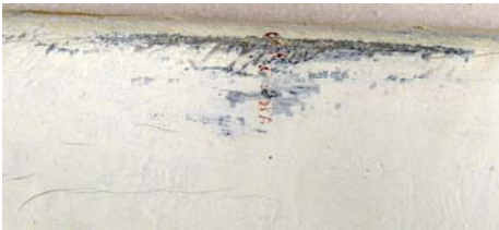
III. 58 Avskrapet maling langs øvre billedkant
