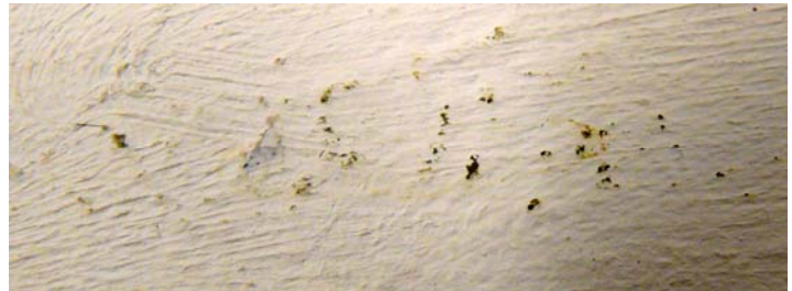
III. 59 Flekker langs øvre langside
