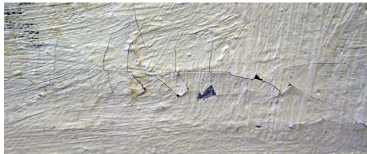
III. 61 Oppskallinger og avskallinger i nedre del av felt 28
