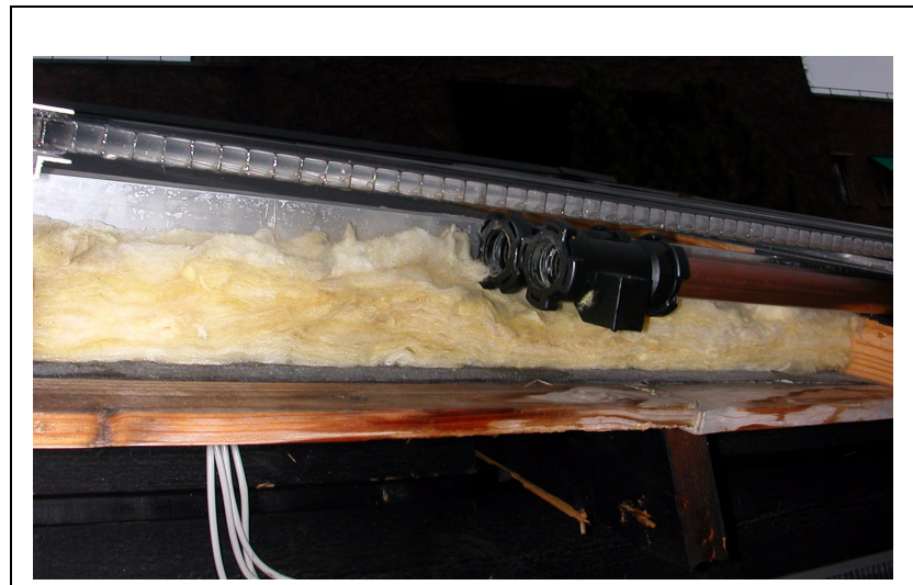
Figur 4.4 Her vises kobberrørene med koblingen som fører vannet til og fra solfangerne. Over absorbatorplata (som er skjult på bildet) sees dekkplata.
