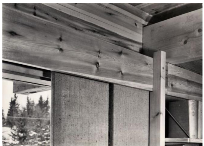
Fig. 49 Wenche og Jens Selmer. Eget hus i Trosterudstien 1 (1963). Eksponert konstruksjon. Fotograf: Teigens Fotoatelier. Datering: 1963-1965. Eier: Arkitekturmuseet.
