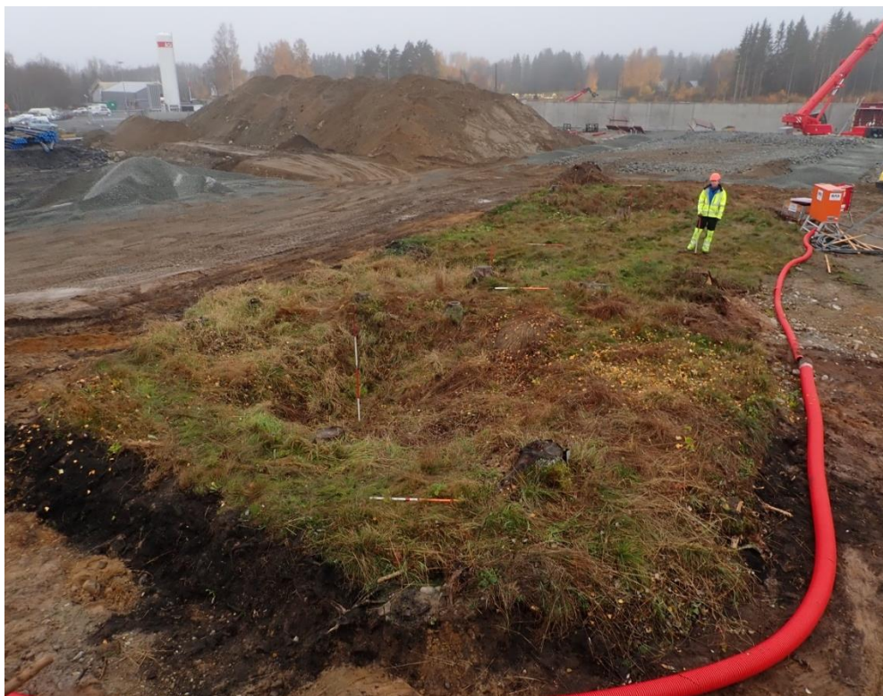
Figur 4. Bilde 411, sett mot sørvest. Oversikt over utgravningsområdet før avtorving. A100008 i forgrunnen. Axel Mjærum står litt nord for midten av flaten mellom A100011 (så vidt synlig bakerst) og A100010 (ikke synlig).
