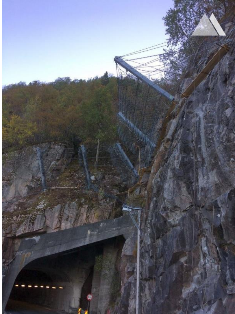
Figur 7: Eksempel på steinspranggjerd. Steinspranggjerd over inngangsparti til tunell i Lensvik i Trøndelag. Gjerdet har en kapasitet på 8000 kJ og er 7 meter høyt. Bilde: Geobrugg.com.
